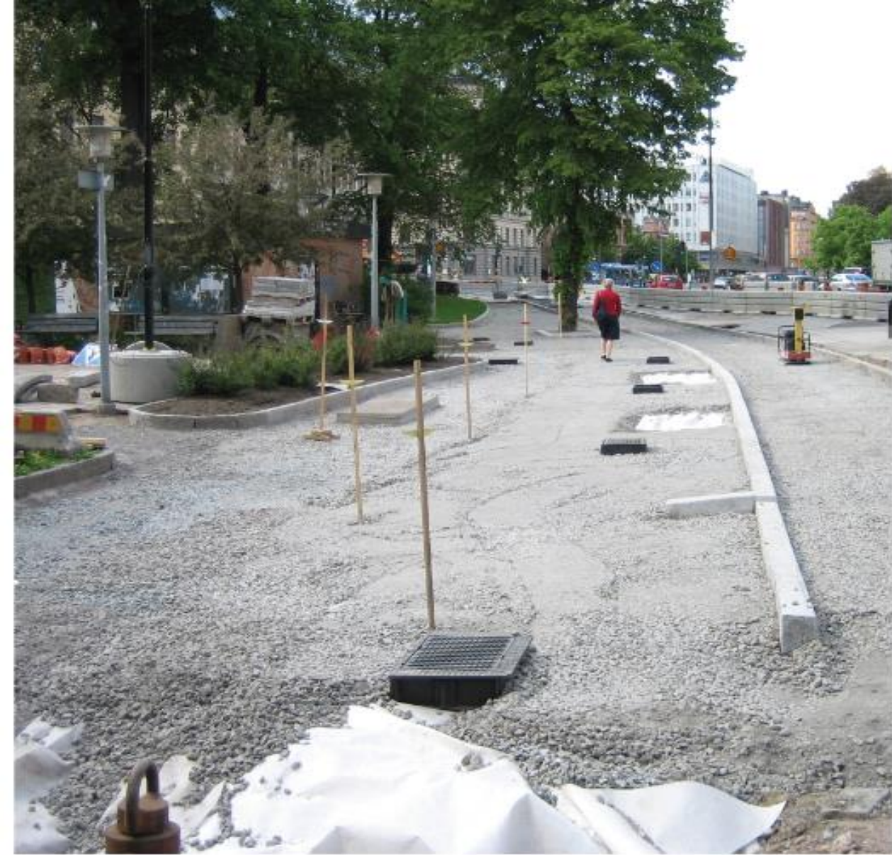
Luft- und Abwasserbrunnen Typ Clarova, hier mit Abdeckungen aus vergütetem Eisen, und komprimierte Tragschicht. Die Strecke enthält sowohl neue Pflanzgruben als auch Pflanzgrubenrenovierungen für vorhandene Strassenbäume.
