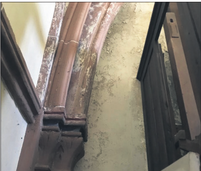
Schäden an den Wänden.
