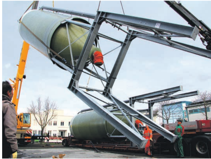
Betriebschefe Thorsten Heberer an der stahlverzinkten Trägerkonstruktion, auf der die neuen Silos ruhen.
