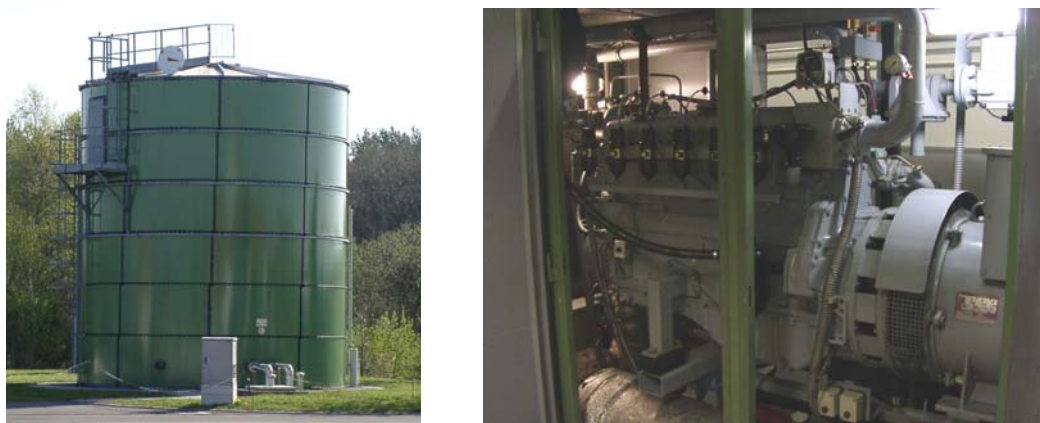
[Bild 42 + 43: links → Gasbehälter; rechts → Blockheizkraftwerk (BHKW)]
